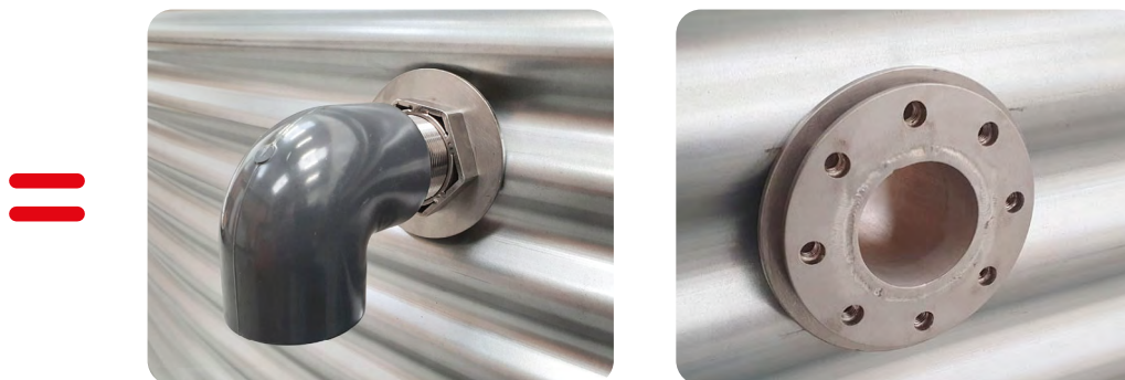
Vue extérieure trop-plein citerne.
